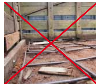
GRADES TORCIDAS E QUEBRADAS
