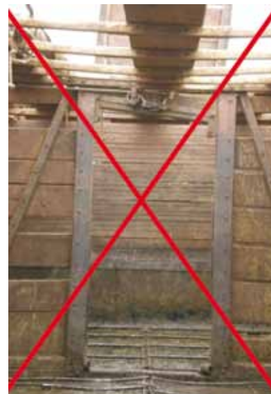
COMPARTIMENTO DE CARGA EM MAL ESTADO DE CONSERVAÇÃO
